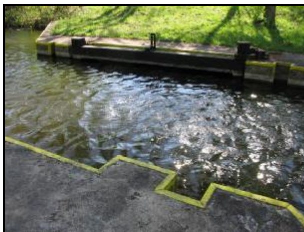
Fot. 6. Ligi – wrota przeciwpowodziowe
